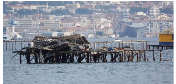
Installation mytilicole abandonnée depuis des années (43°04'55.0"N - 5°54'20.1"E)
